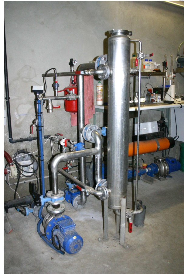
Chauffage électrique et mesures pH et T°
